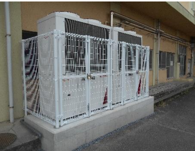
調理場 室外機
