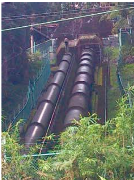
発電するための送水管
