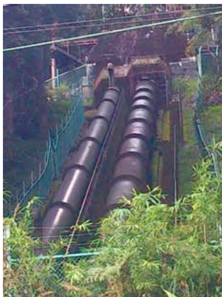
発電するための送水管
