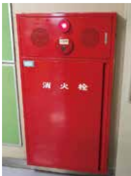
学校の消火栓
