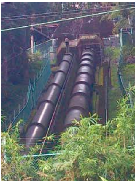
発電するための送水管
