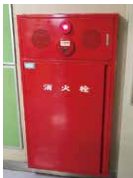
学校の消火栓
